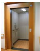
エレベーター
